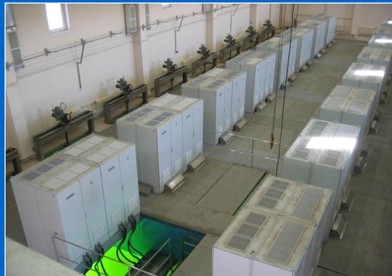
Люберецкие очистные сооружения, г. Москва 1 000 000 м 3 /сут
