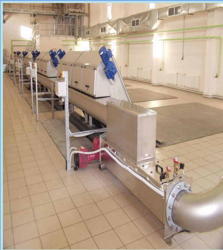
Отделение процеживания сточных вод через механические сита с прозорами 1,4 мм
